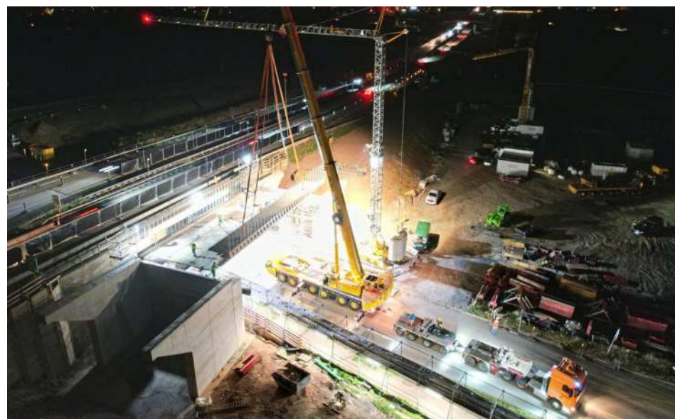
Nachtarbeit: Von Samstag auf Sonntag werden vier Bauteile für den Überbau in die Widerlager eingehoben. Foto: Tobias Jäger/Autobahn GmbH Südwest
